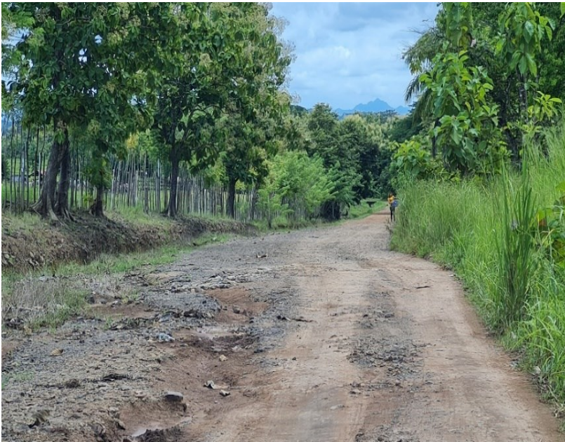
Figura 27 Vía Arterial sin pavimento. Fuente: Equipo Consultor
